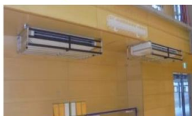
体育館のエアコン
