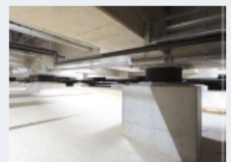
地下免震装置
