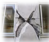
耐震化未完了の建物が 大規模地震により大きな 被害を受けた例
