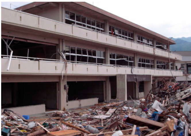
津波により被害を受けた校舎
