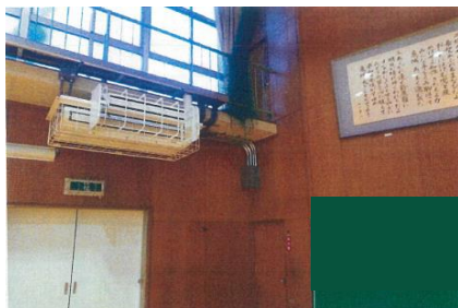
天井吊型空調機
