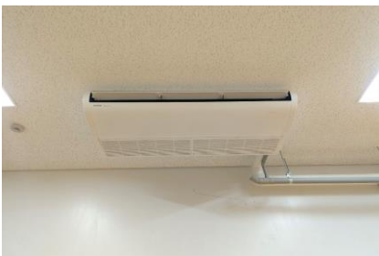
天井吊型空調機(格技場)
