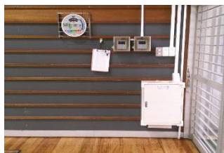
リモコンボックス 非常用電源ボックス
