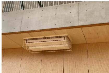
天井吊型空調機
