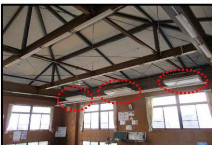
天井吊型空調機②
