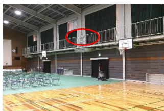
天井吊型空調機
