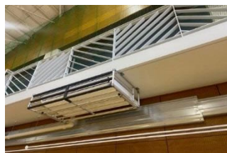
天井吊型空調機 (キャットウォーク下)
