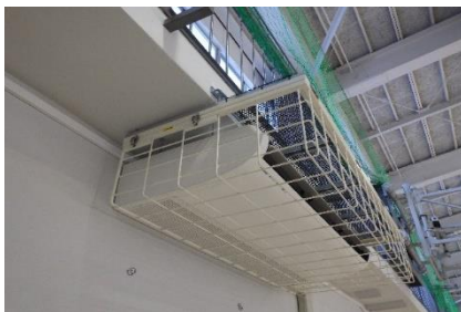
天井吊型空調機(フロア)
