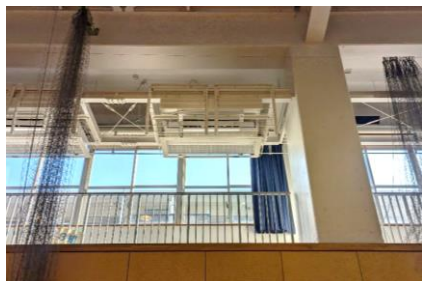
天井吊型空調機(アリーナ)
