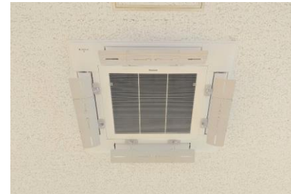
天井カセット型空調機(卓球場)
