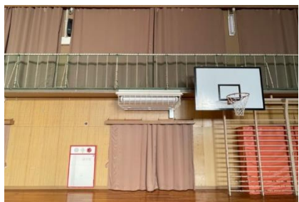
天井吊型空調機
