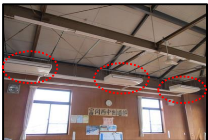
天井吊型空調機①
