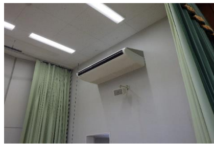
天井吊型空調機(ステージ上)
