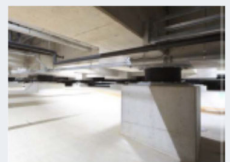
地下免震装置
