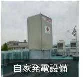
自家発電設備
