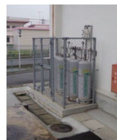
L P ガスのタンク
