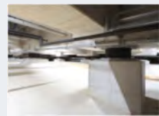
地下免震装置
