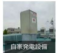
自家発電設備
