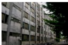
落下の危険がある外壁
