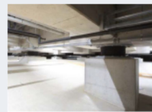
地下免震装置
