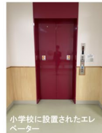
小学校に設置されたエレベーター
