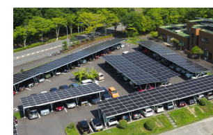
創エネルギー設備の整備
