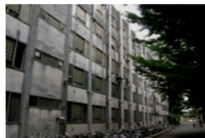
落下の危険がある外壁
