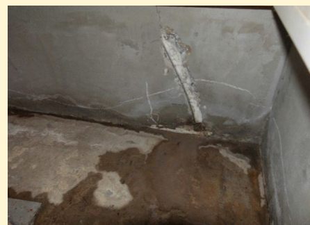
劣化により雨水が浸透している 食堂棟外壁
