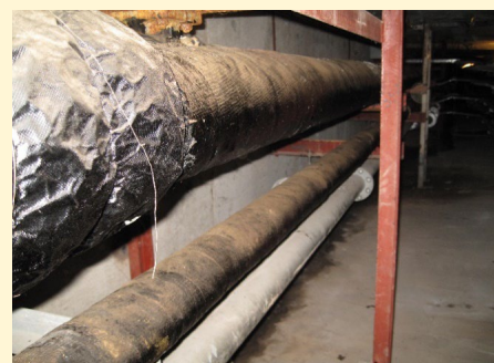
敷設後51年を経過し、腐食がみ られる消火管
