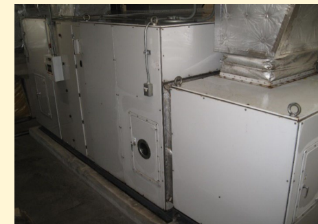
設置後26年が経過し、修理部品 の調達が困難な空調機器
