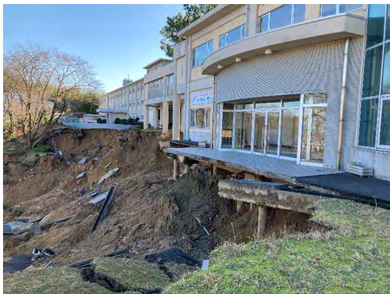
校舎前地盤が崩れ、地中杭が露出
