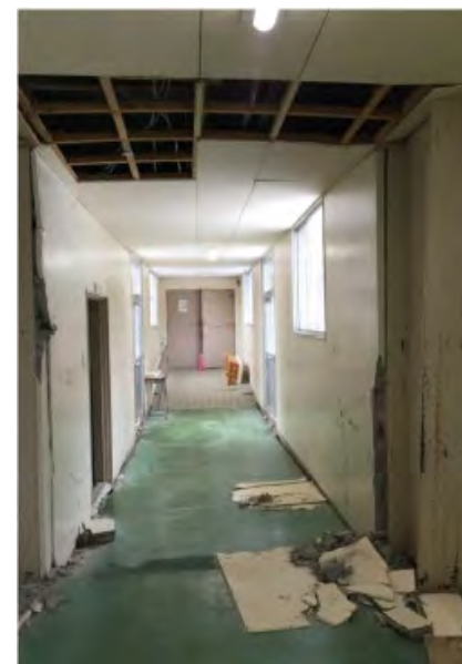
天井、内壁の落下
