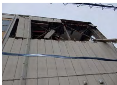
校舎の外壁板崩壊
