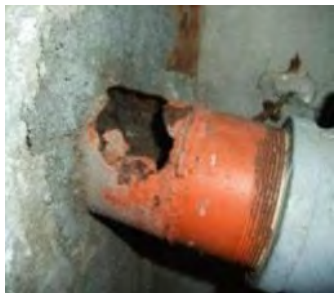
劣化による配管破損
