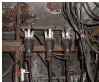
電気ケーブルの劣化
