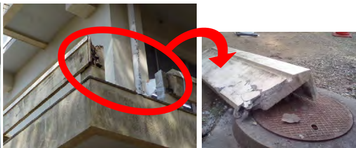
老朽化により手すりが落下
