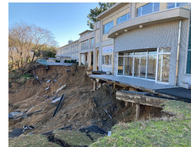
校舎前地盤が崩れ、地中杭が露出
