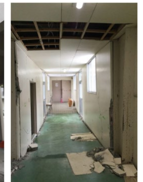
天井、内壁の落下
