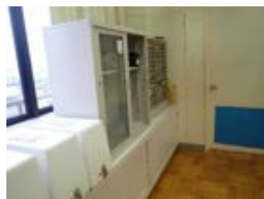
写真2 積み重ねられ 固定されていない棚
