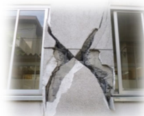
耐震化未完了の建物が大規模地震により甚大な被害を受けた例
