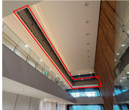
崩落した4階下がり壁
