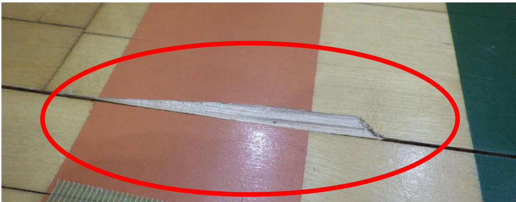
床板が剥離した箇所 大きさ：7 cm × 0.6 cm（最も幅広の箇所）
