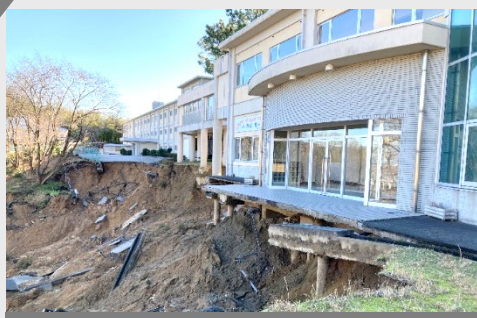
校舎前地盤が崩れ、地中杭が露出
