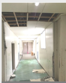
天井、内壁の落下
