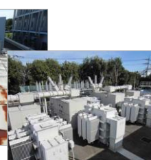
理研和光地区の 特高変電設備
