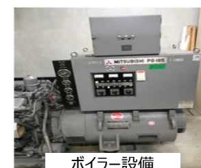
ボイラー設備
