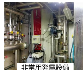
非常用発電設備
