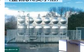
〈整備した受水槽〉
