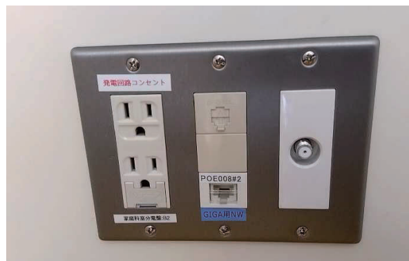
家庭科室の非常用コンセント
