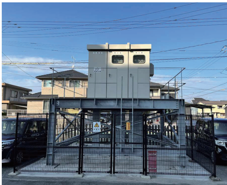
みなと小学校のキュービクル
