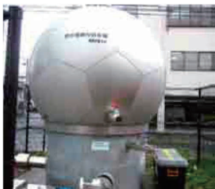
貯水機能付給水管
