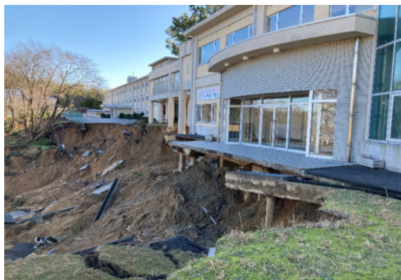
令和6年能登半島地震で生じた法面崩壊及び建物被害
