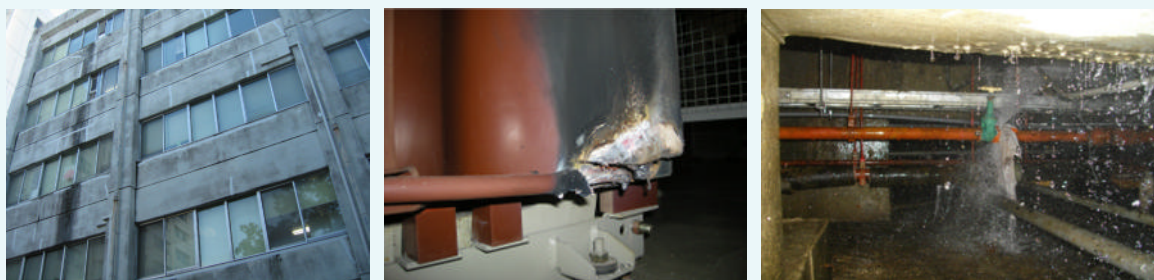
図表 2-10-6 国立大学等施設の老朽化状況
