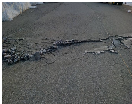
アスファルト破損
