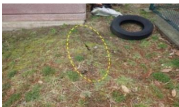
地表面の亀裂
