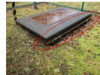
地震計ピット（マンホール）の浮き上がり
