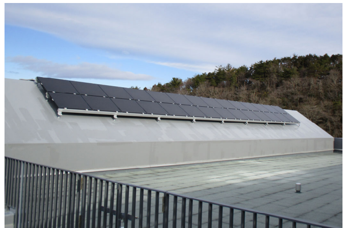
体育館の屋根に設置された太陽光発電パネル (発災時には電源として活用できる)
