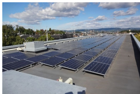
屋上に設置された太陽光発電設備
