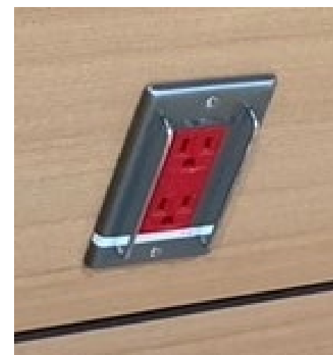
コンセント (停電時使用)
