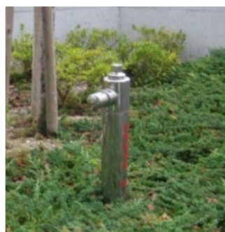
停電時にも給水が可能な応急給水栓 ＜愛媛県松山市＞
