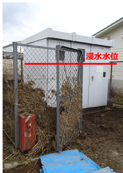
受変電設備浸水 (令和元年東日本台風)
