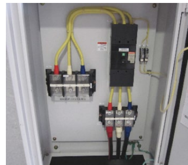
停電時に電源車に接続するための電源接続盤 ＜新潟県長岡市＞
