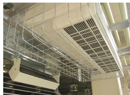
L P ガスを用いた体育館の空調システム ＜大阪府箕面市＞
