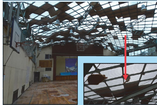
屋内運動場屋根ふき材等の飛散
