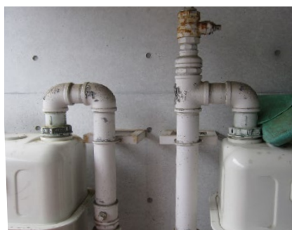
都市ガスエリアでも災害時にLPガスを使用できるよう変換機の接続口を整備 ＜新潟県長岡市＞
