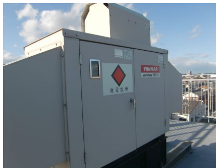
浸水対策として屋上に設置されている自家発電設備 ＜三重県四日市市＞
