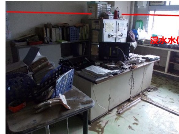
被災時の1階職員室
