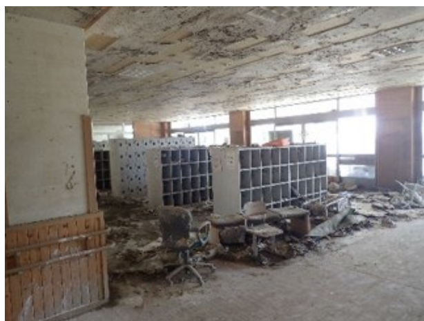
校舎浸水 (平成30年7月豪雨)
