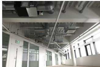
高効率空調の整備
