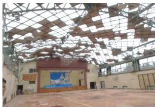
台風で屋根が消失した体育館
