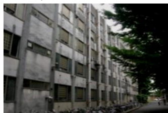
落下の危険がある外壁
