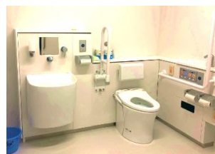
バリアフリートイレの整備
