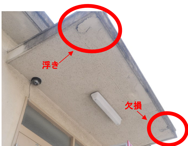
【事例 11】出入口上部の底のモルタルの浮き（手前）とコンクリートの破損（奥） （写真提供：（一財）日本建築防災協会）
