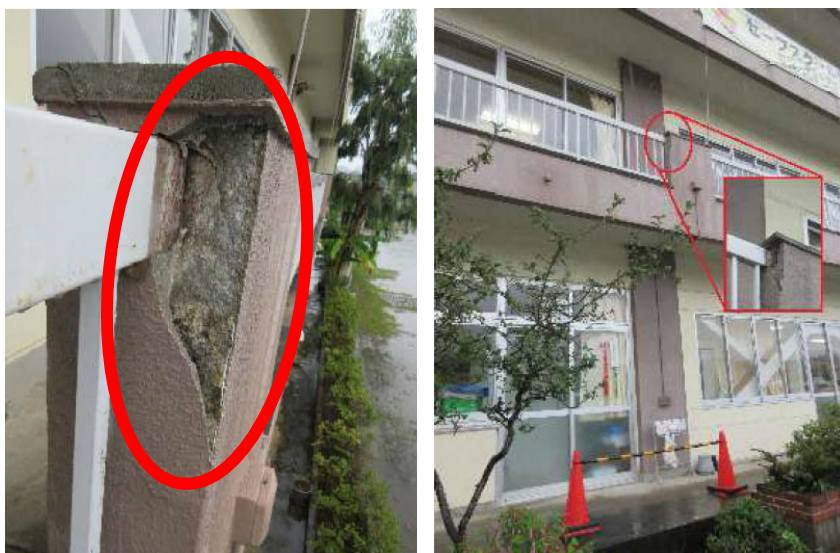
【事例 13】校舎の 2 階ベランダ立ち上がり壁のコンクリートの一部が落下。 落下片大きさ：9cm×29cm×5.5cm
