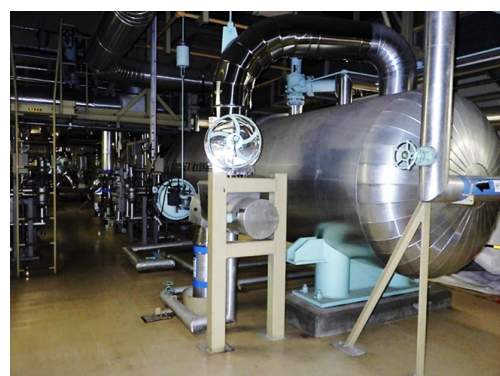
高圧給水加熱器
