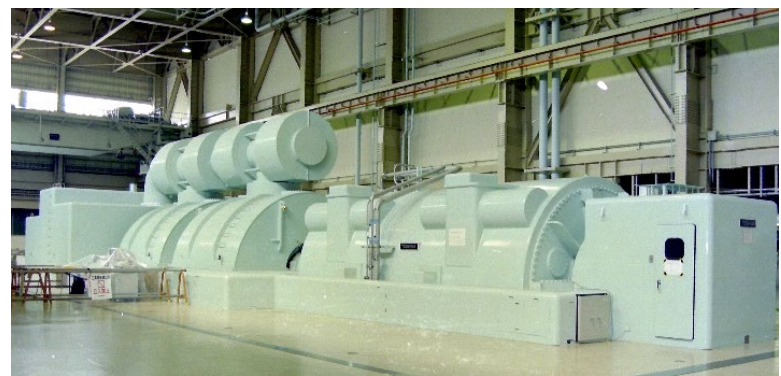
タービン発電機（タービン建物3階）
