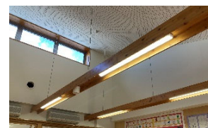
LED照明、明るさセンサー
