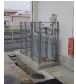
LPガスのタンク
