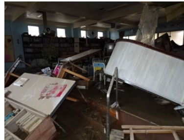
令和2年7月豪雨の被害
