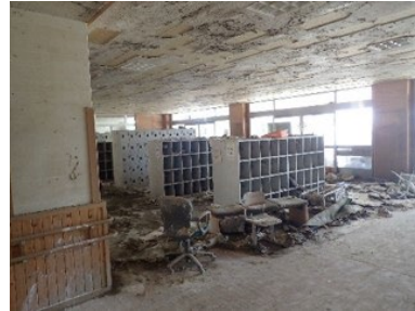
平成30年7月豪雨の被害
