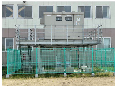
＜架台の上に設置された受変電設備＞
