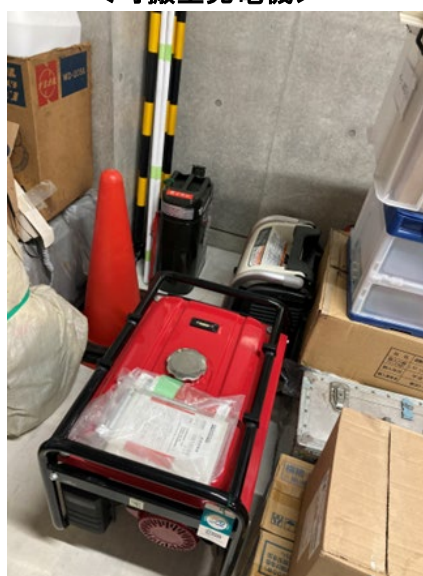
＜可搬型発電機＞
