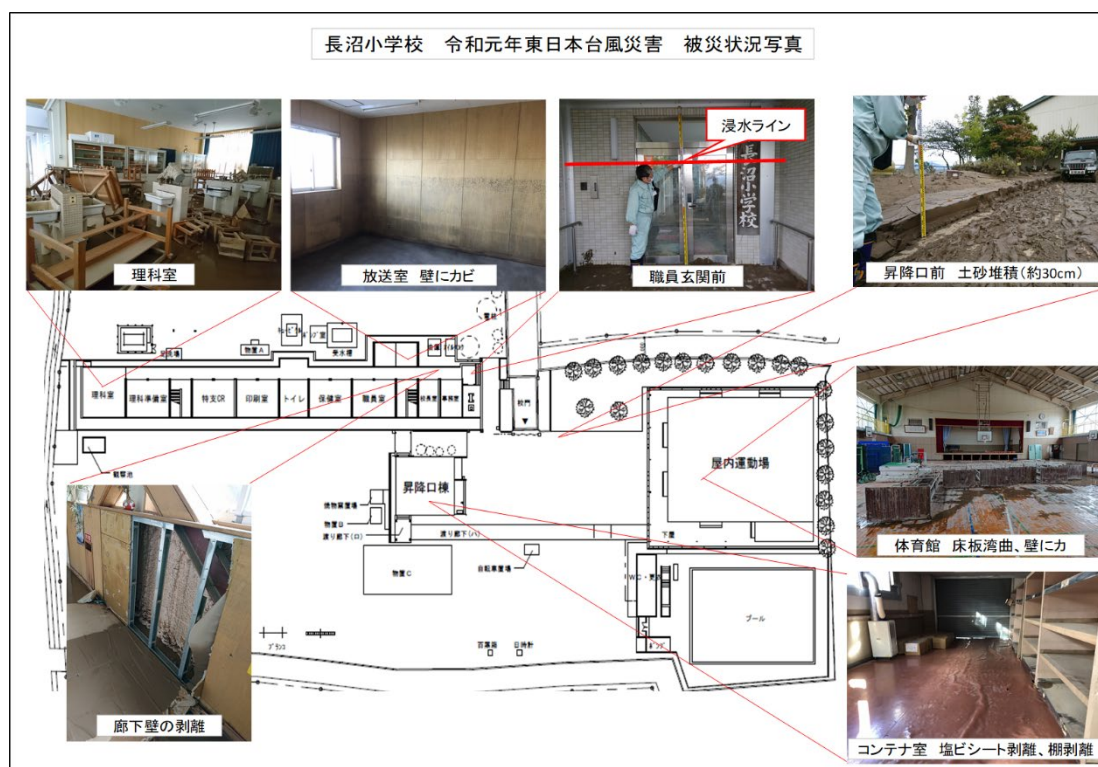
学校の被害状況
