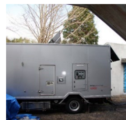
電源車の配備
