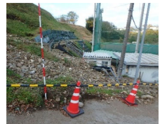
土砂崩れに対する立入禁止措置
