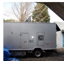
電源車の配備
