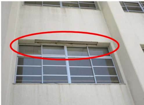
外壁の下端のモルタルが落下
