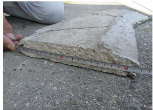
落下したモルタル
