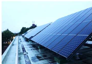
創エネルギー設備の整備
