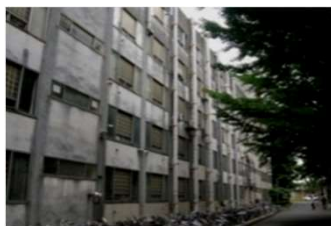
落下の危険がある外壁
