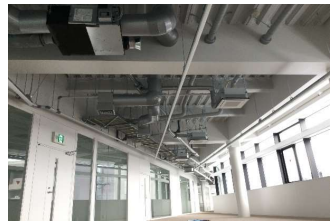
高効率空調の整備
