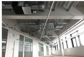
高効率空調の整備
