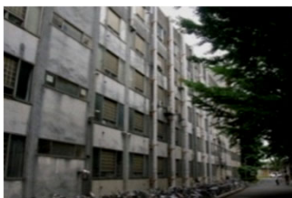
落下の危険がある外壁
