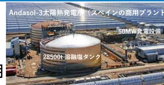
蓄熱設備の例(海外)
