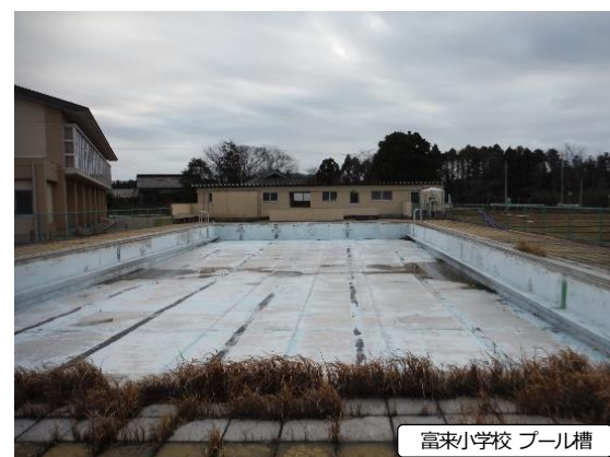
富来小学校 タイル劣化
