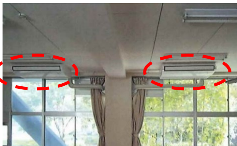
◆ 普通教室に設置された空調設備 ※滋賀県湖南市提供
