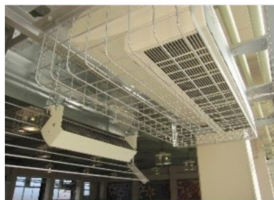
◆ 体育館に設置された空調設備
