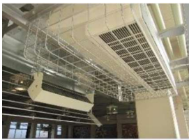
◆体育館に設置された空調設備
