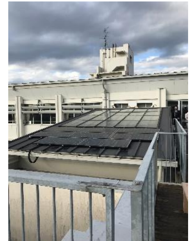
太陽光発電設備
